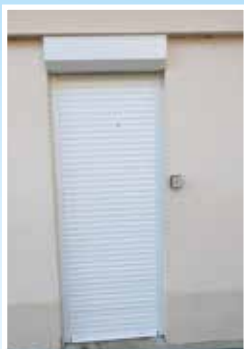
Menuiseries du bureau de la direction de l'école
